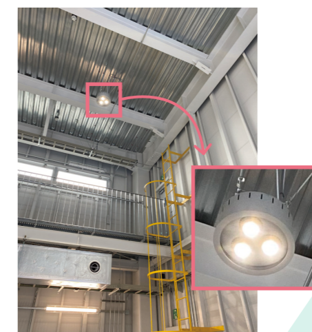
ヒートパイプLEDの設置状況
